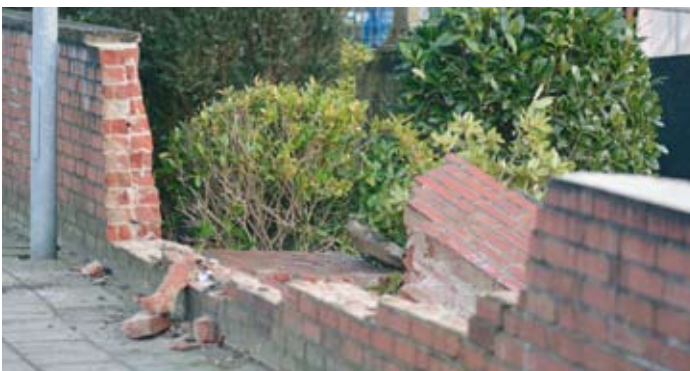
In der Nacht zum 3. Februar wurde die Mauer an der Evangelischen Kirche in Cloppenburg von einem ins Schleudern geratenen Fahrzeug teilweise eingerissen. Der Fahrer meldete sich nach dem Vorfall unaufgefordert bei der Polizei. Die Mauer soll demnächst in Rücksprache mit der Versicherung des Fahrzeughalters wieder errichtet werden. (wk)
